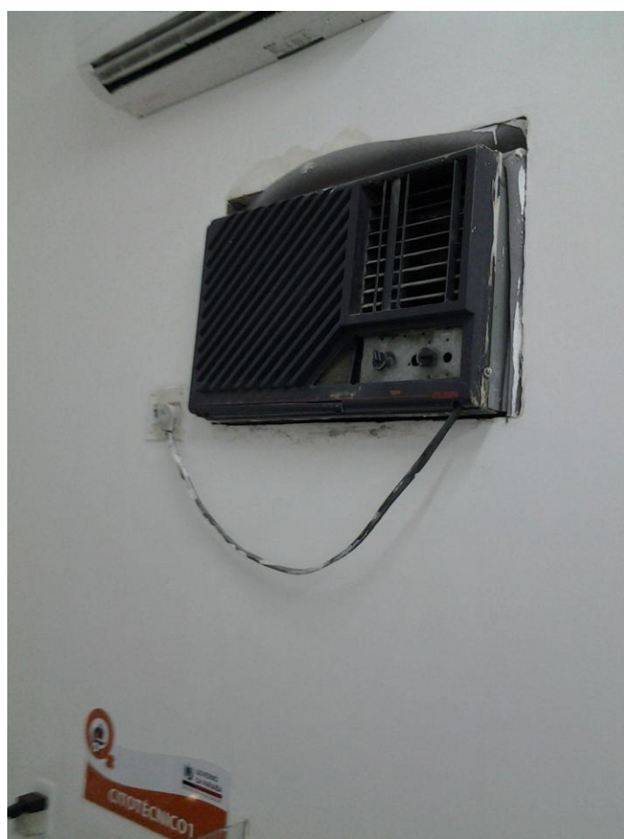
Instalações elétricas inadequadas
